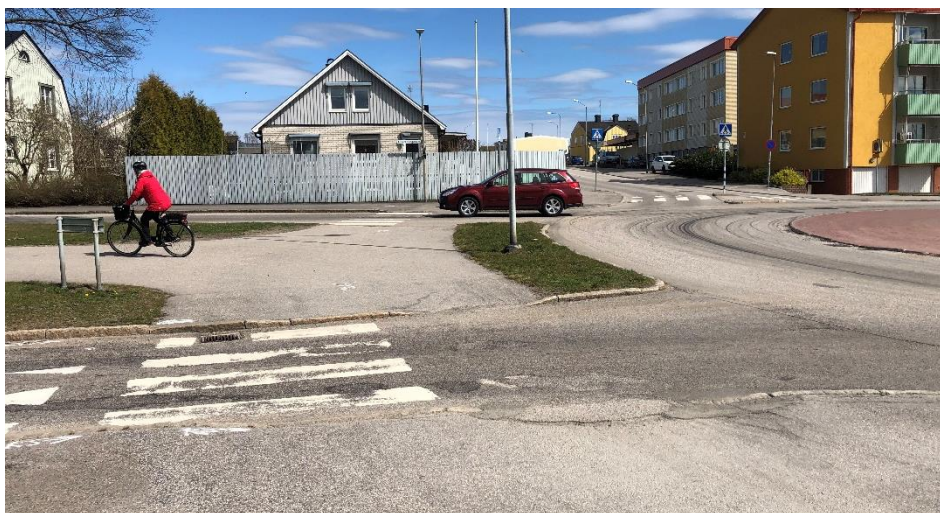
Figur 20 Övergångsställe över Albert Tengers väg vid cirkulationsplatsen. Sliten målning och avsaknad av hastighetsdämpande åtgärder.
