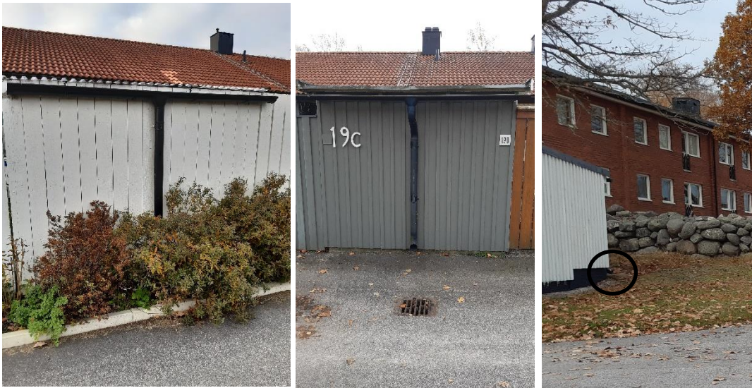
Figur 12. Exempel på avvattning av takytor för komplementbyggnader och garage inom kvarteret Topasen 2. Utkastare från garagetak är markerad i svart. (Foto: VME)
