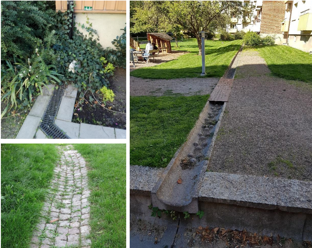
Figur 27. Exempelbilder på olika typer av rännor för ytlig avledning av takvatten (Foto: Tyréns)
