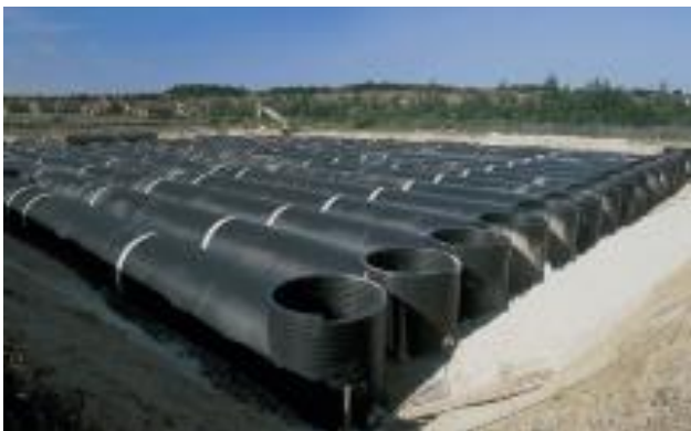
Figur 28. Exempel på större rörmagasin (Foto: Stockholm Vatten och avfall, okänt år).
