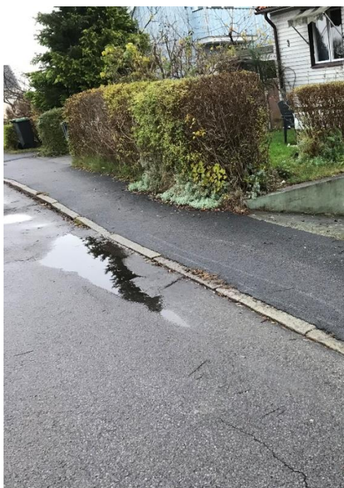
Figur 15. Vy tagen sydöst längs med Svangatan. På bilden syns stående vatten i lågpunkt mittför nedsänkt garagednart och nedsänkt kantsten vid fastighet som kan riskera att drabbas vid skyfall.
