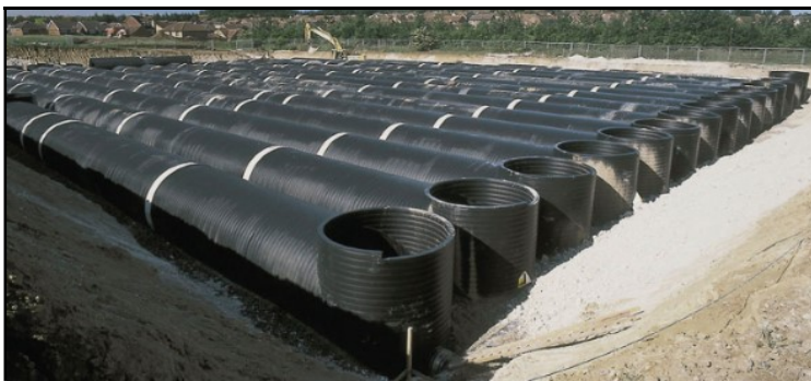
Foto 4. Exempel på rörmagasin (Stockholm Vatten).
