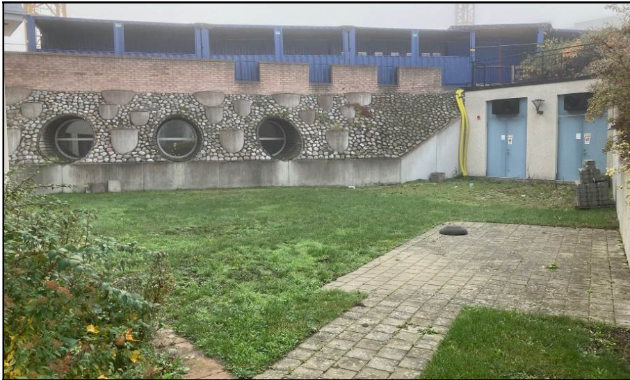
Foto 3. Vid Hus 20 mot sydväst. Innesluten lågt liggande markzon invid ställverk, risk vid skyfall
