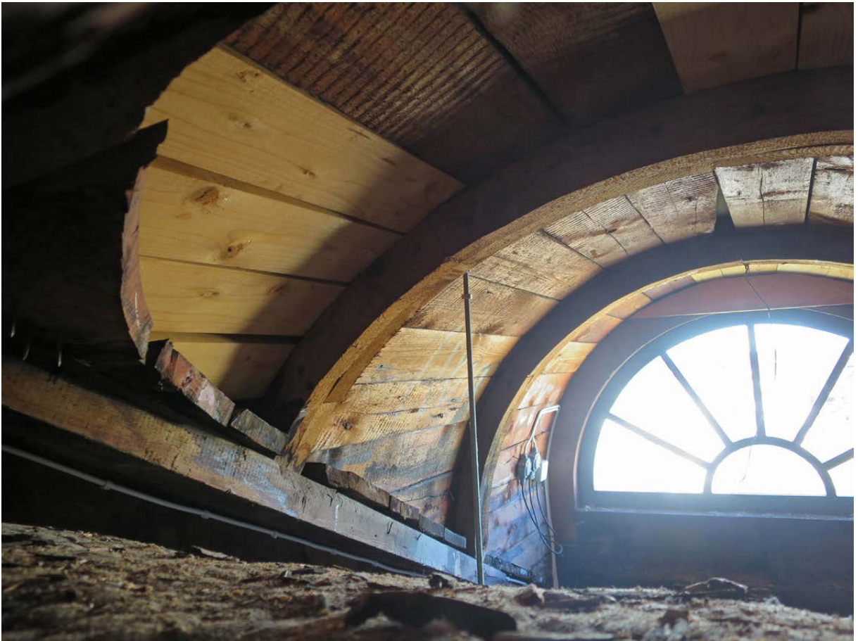
Vid takkuporna kan man se det ursprungliga ramsågade virket men här har också lagningar gjorts i senare tid.
