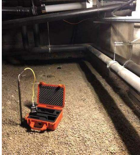
Porgasmätning vid L (underkulvert)
