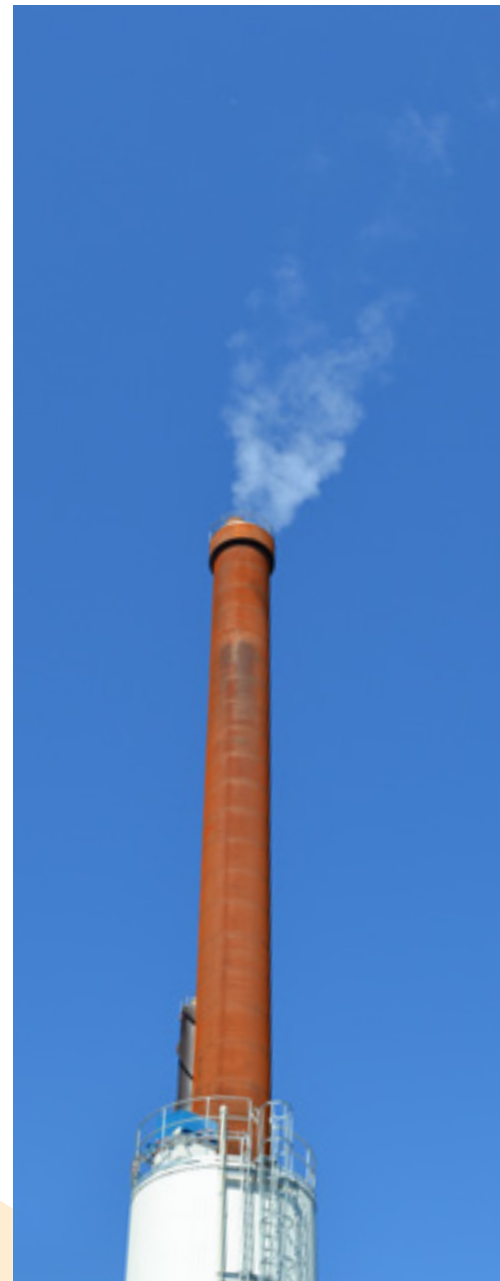
SKORSTENEN TILL PANNA 5
