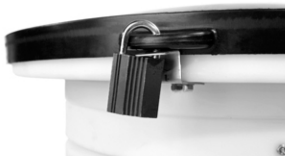
Figur 7. Lås pumpstationen med ett hänglås.
