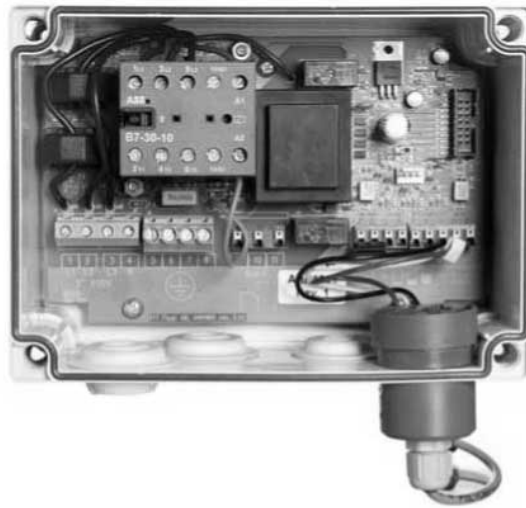
Figur 3: En färdig installation
